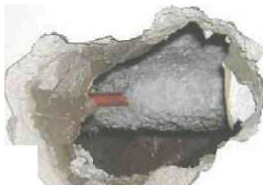
Rys.7 Azbestowa izolacja rury
