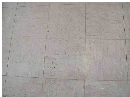
Rys.8 Płyta podłogowa azbestowa
