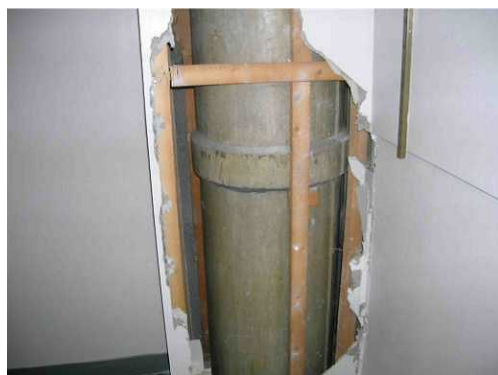
Rys. 6 Azbestowo-cementowy kanał dymowy z obudową z płyty azbestowej
